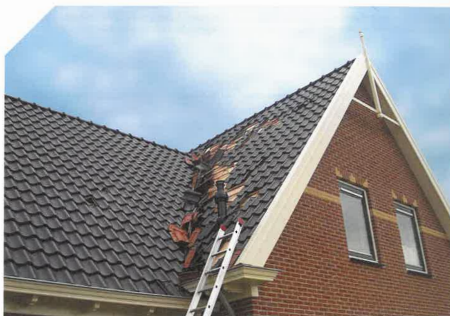
▲ Gefahr im Verzug: Herabfallende Dachpfannen können Sach- und Personenschäden verursachen
