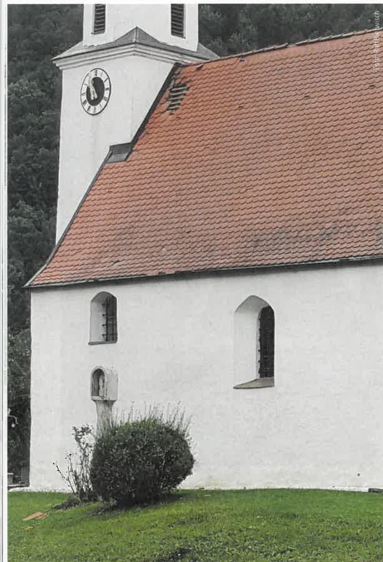
Verwirbelungen im Bereich des aufgehenden Kirchturms haben zum Sturm- schäden am Gotteshaus im österreichischen Pyrawang geführt.
