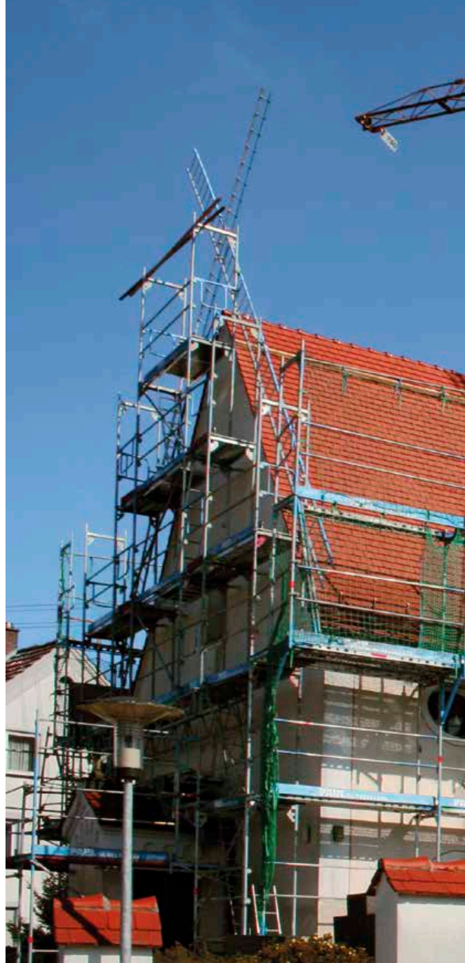
▲ Sanierung des Kirchendaches in Bubenhausen: Aspekte der Windsogsicherung und des Denkmalschutzes waren relevant
