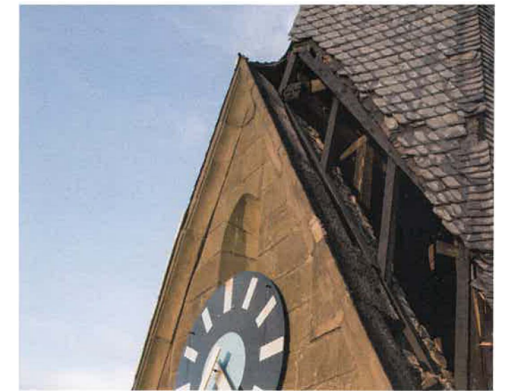
Beispiel Dachschaden an der St. Laurentius Kirche in Essen-Steele verursacht durch das Orkantief Friederike am 18. Januar 2018.
